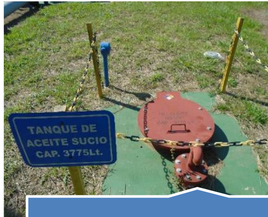
Almacenamiento temporal en pozos slop.
