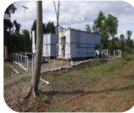
Plantas de tratamiento de agua (Red Fox) en campamentos
