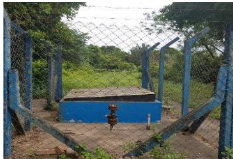
Válvulas Check o de retención en cruces de cuerpos de agua
