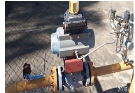
Válvulas de operación remota o telecomandadas.
