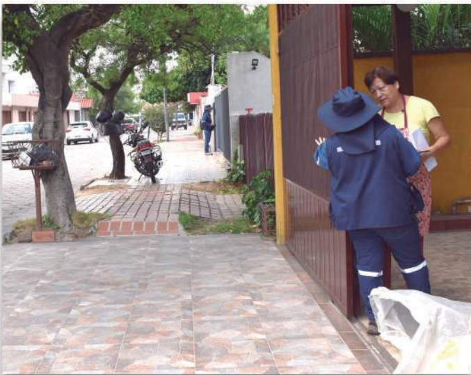
Renovación de la red de Agua Potable En la UV 37 Parcial Barrio Hamacas
