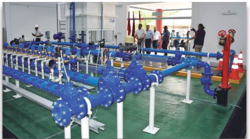
Redes de agua potable en el Simulador Hidráulico
